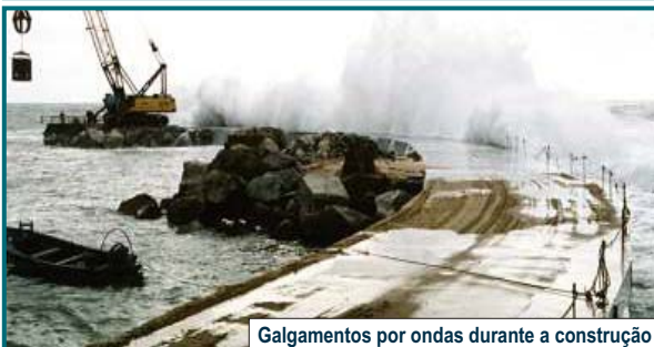
Galgamentos por ondas durante a construção
