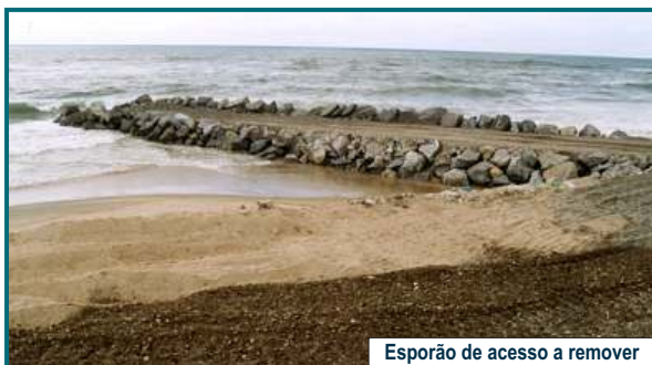
Esporão de acesso a remover
